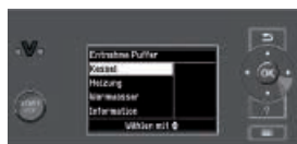
Régulation Ecotronic à menu déroulant avec affichage du texte en langage clair et intuitif (mise en service facilitée par la fonction Plug and Work)
