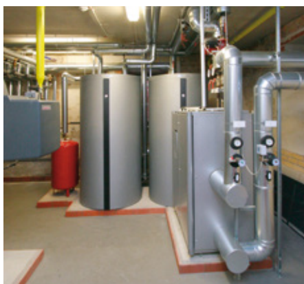
Cogénération Vitobloc 200 avec 2 ballons tampon Vitocell 100-E
