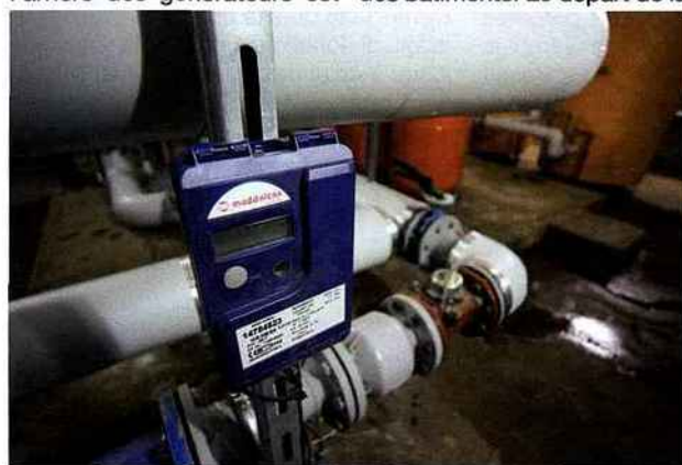
Toutes les sous-stations sont équipées d'un compteur d'énergie.
