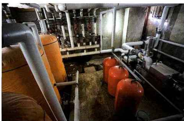
Cette sous-station équipée d'un échangeur de 730 kW alimente un bâtiment de salle de cours. Elle a été implantée après le retrait de deux chaudières gaz.
