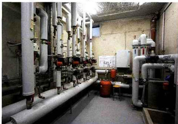
La sous-station d'un bâtiment récent BBC-HQE. Elle est équipée d'un échangeur à plaques de 240 kW.
