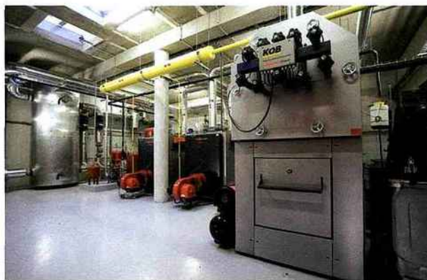
La chaufferie est composée d'une chaudière bois de 720 kW et de deux chaudières gaz de 1,2 MW. Au fond, le ballon-tampon de 6 000 litres.
