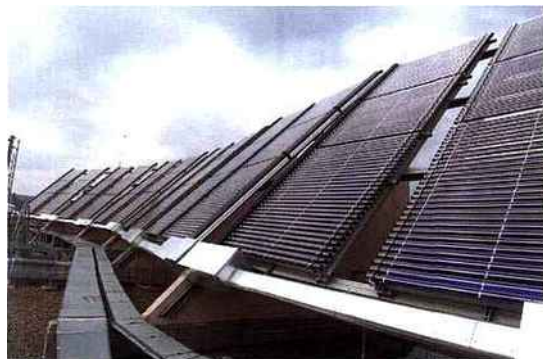
La nouvelle installation solaire : 14 séries de 3 capteurs à tubes sous vide (Photo BEF Hugue)
