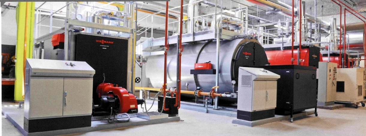
▲ Vue générale de la chaufferie rénovée. De gauche à droite : chaudière 1 MW (modèle Vitoplex 300 TX3A), chaudière 2,8 MW (modèle Vitomax 200 Lw), les deux anciennes chaudières de 3,6 MW chacune (modèles CHD03 et CHD04), toutes de la marque Viessmann.
