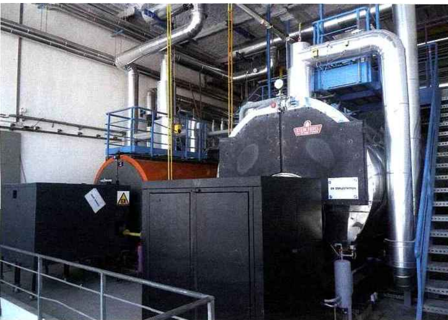
Deux des anciens générateurs ont été conservés et techniquement rénovés : une Stein Fasel de 4 870 kW et une Viessmann Turbomat de 4 700 kW.
