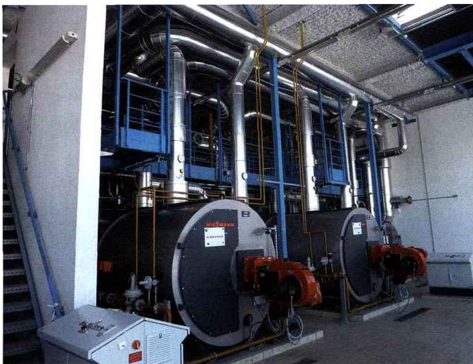
Les trois nouvelles chaudières Viessmann Vitomax 300 fioul/gaz, équipées de brûleurs Multiflam de Weishaupt. Au premier plan, les deux chaudières de 3,5 MW, à l'arrière, celle de 1,86 MW.
