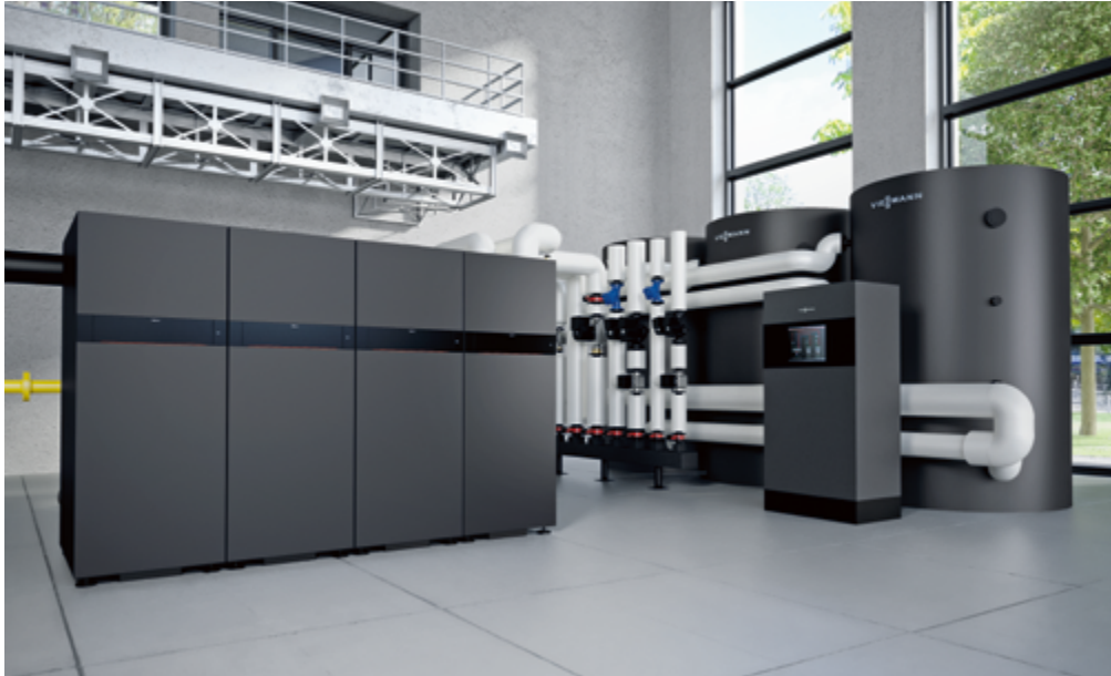
Chaudière gaz à condensation Vitocrossal 300 CI3 en cascade de 4 chaudières, réservoir tampon d'eau primaire Viticell (de gauche à droite)
